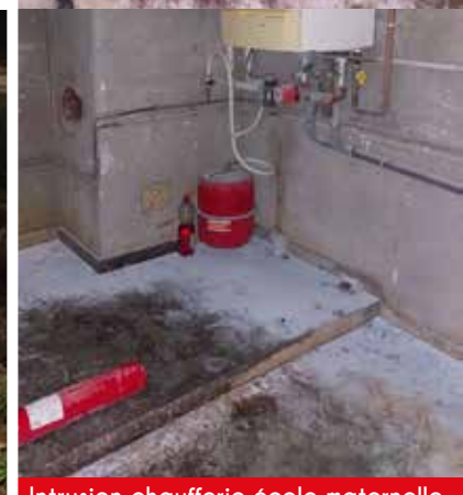
Intrusion chaufferie école maternelle, serrure cassée, extincteurs percutés et vidés dans le local
